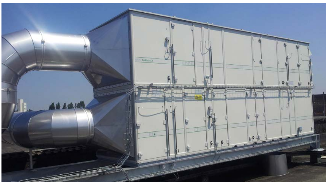
Centrale de traitement d'air CAIRplus® montée en toiture
