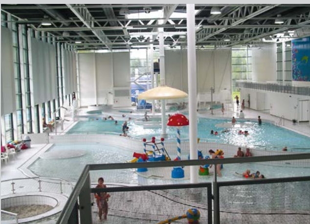
Leegwaterbad, Pumerend, Pays-Bas CAIRFricostar avec récupérateur de chaleur et pompe à chaleur.
